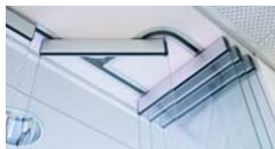
収納スペース用カバーにより天井のレールの納まりはきれいです。
